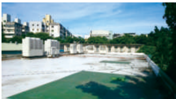
圖 7：體檢中心防漏工程整修前
