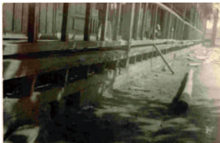
▲ 44 年，病房走廊腐朽、坍塌情形。(之一)
