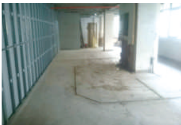
圖 3：化療調劑室及門診中心公廁整修前
