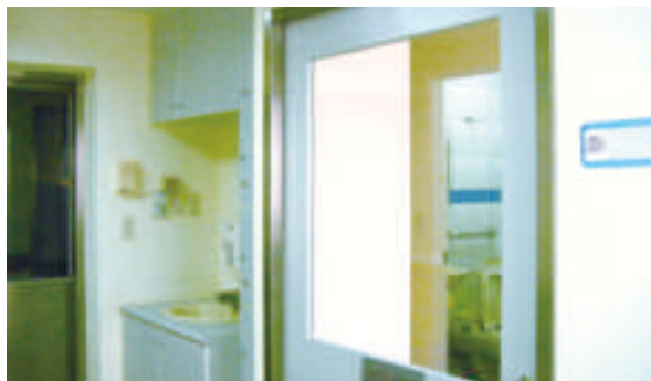
圖 5：隔離病房設施（前置室）
