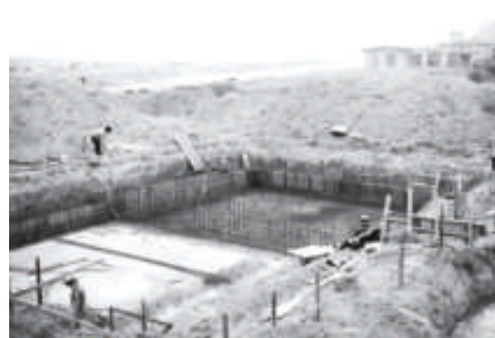
污水處理過濾池
