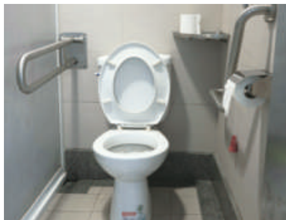
圖 8：廁所設置扶手。
